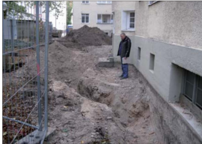
Für den Einbau von Rigolen zur Versickerung des Regenwasser wurden Anfang November tiefe Gräben im Hof ausgehoben Foto: cws
