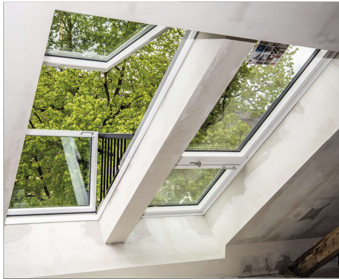
Die großen Cabrio-Fenster lassen viel Licht in die Wohnung und werden mit zwei Handgriffen zu Balkonen
